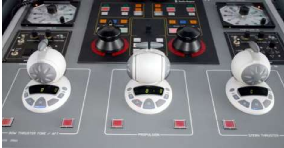
Slika 46. Komande na mostu [26]
