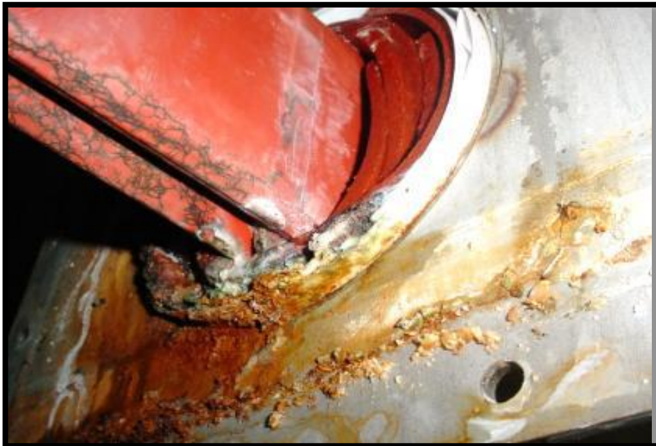
Slika 48. Kvar uzemljenja sustava sabirnica od 11 kV. Vjerojatni uzrok: nepravilan izolacijski materijal i vlaga [1]
