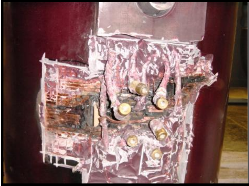
Slika 51. Lom izolacije u zavojnici distribucijskog transformatora(6,6 kV) od lijevane smole . Vjerojatni uzrok: greška u proizvodnji [1]
