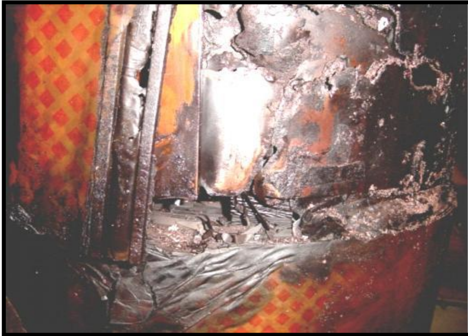
Slika 47. Kratki spoj od skretanja do skretanja u sekundarnom namotu pogonskog transformatora s uljem. Vjerojatni uzrok: greška u proizvodnji [1]
