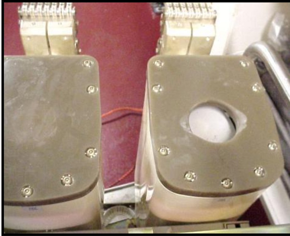
Slika 49. Probijanje pola SF6 prekidača. Vjerojatni uzrok: greška u proizvodnji [1]
