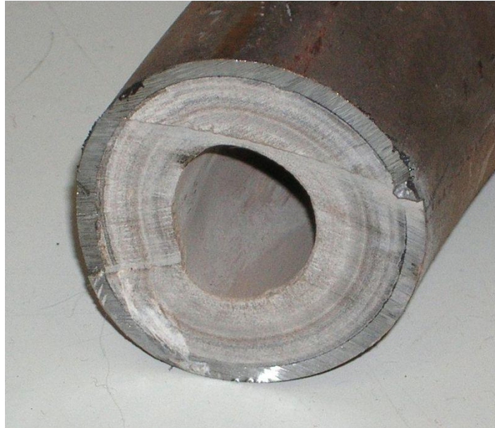
Slika 13. Talog kamenaca u cijevi generatora pare [15]
