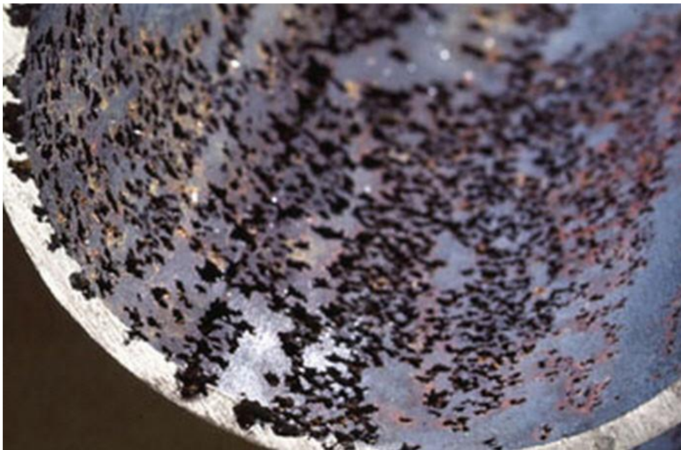
Slika 15. Točkasta (pitting) korozija u cijevi generatora pare [24]
