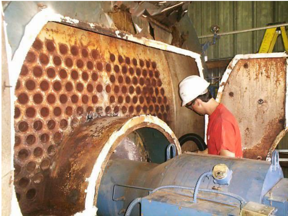
Slika 14. Korozija generatora pare [18]
