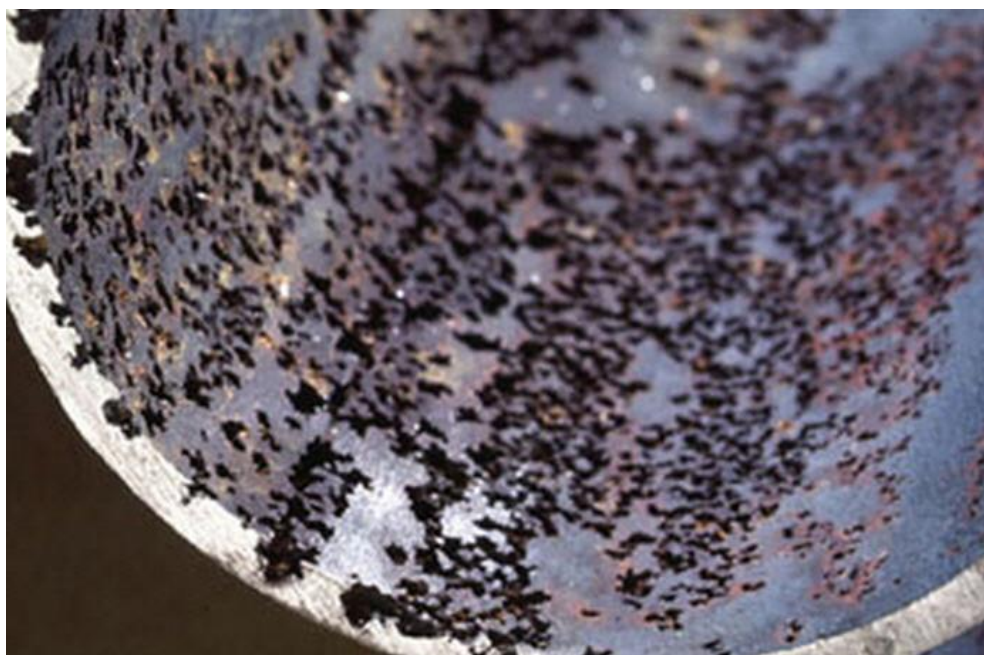
Slika 15. Točkasta (pitting) korozija u cijevi generatora pare [24]
