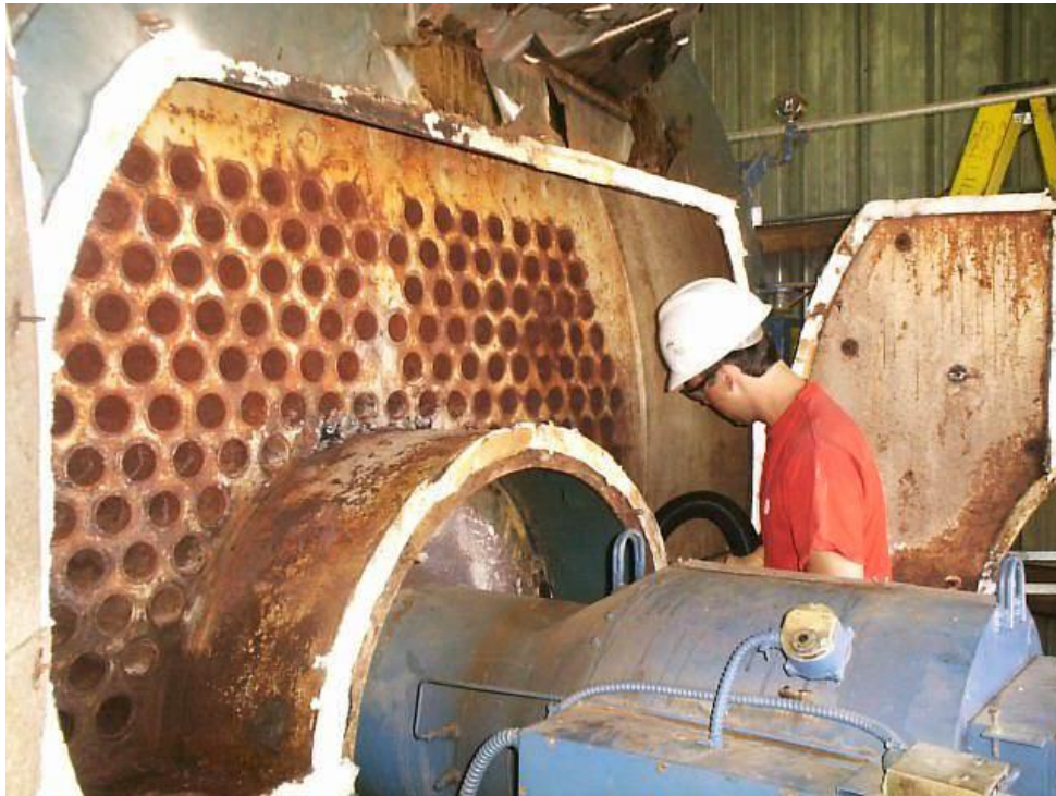
Slika 14. Korozija generatora pare [18]
