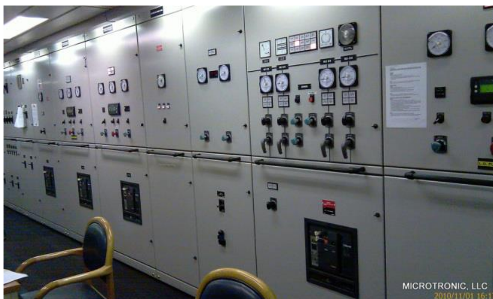
Slika 19. Prikaz glavne sklopne ploče [9]
