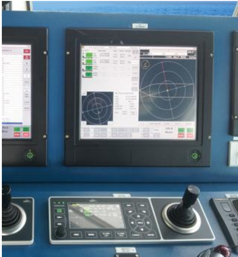
Slika 13. Upravljačka ploča DP sustava [16]
