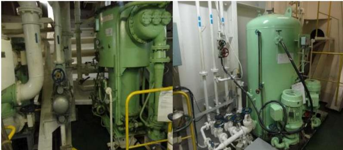
Slika 5. Generator slatke vode na LNG brodu [11]
