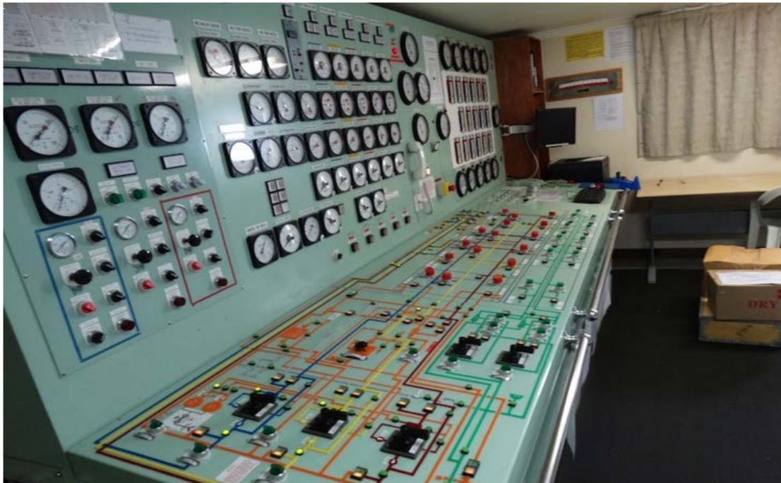
Slika 10. Ploča za upravljanje balastnom vodom [16]
