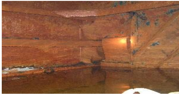
Slika 25. Učinci korozije na tankovima za teret[6]
