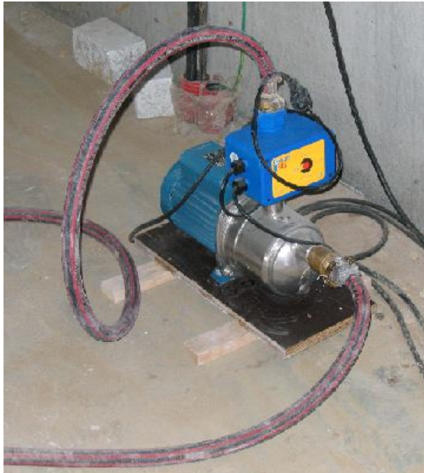
Slika 5. Pumpa na električni pogon
