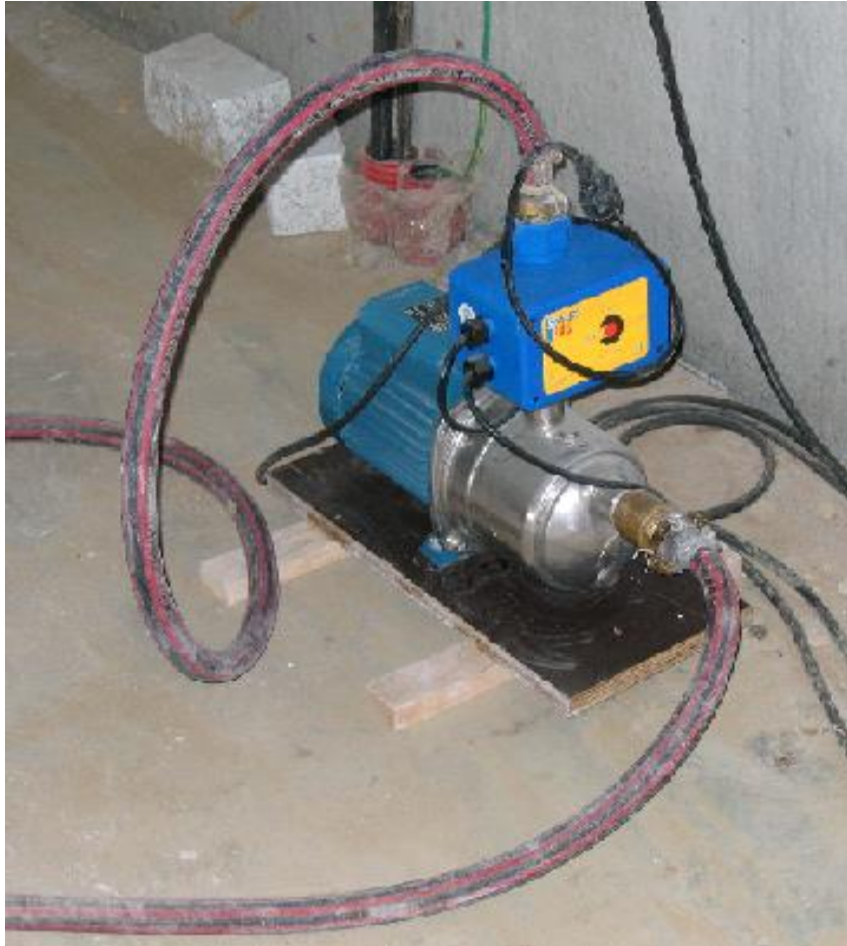
Slika 5. Pumpa na električni pogon
