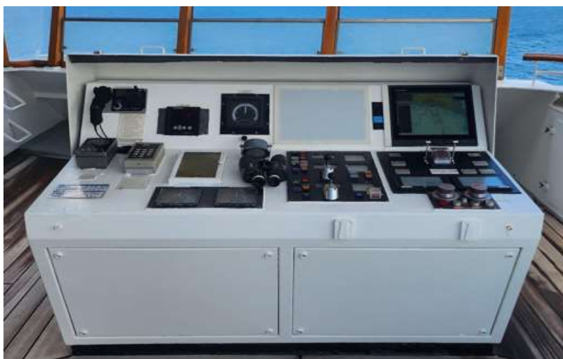
Slika 12. Stanica za manevriranje na krilu mosta
