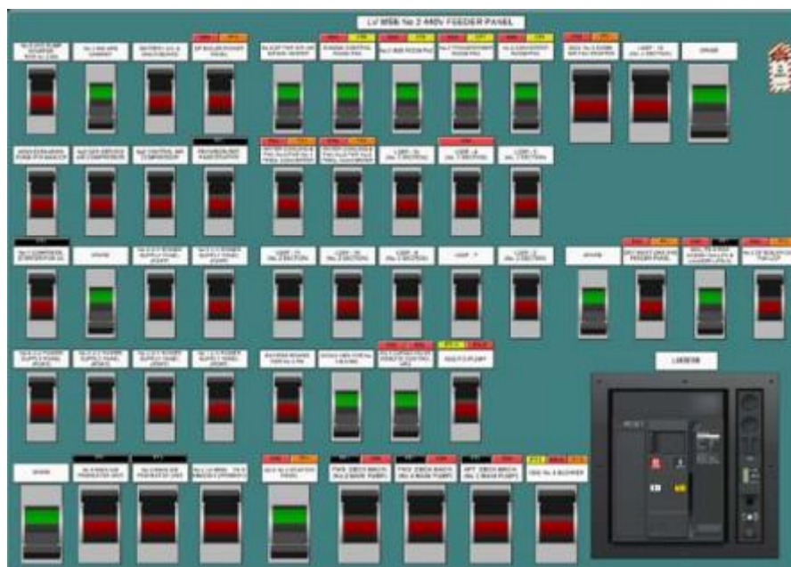
Slika 29. Napojna niskonaponska sklopna ploča GSP 2 440 V
