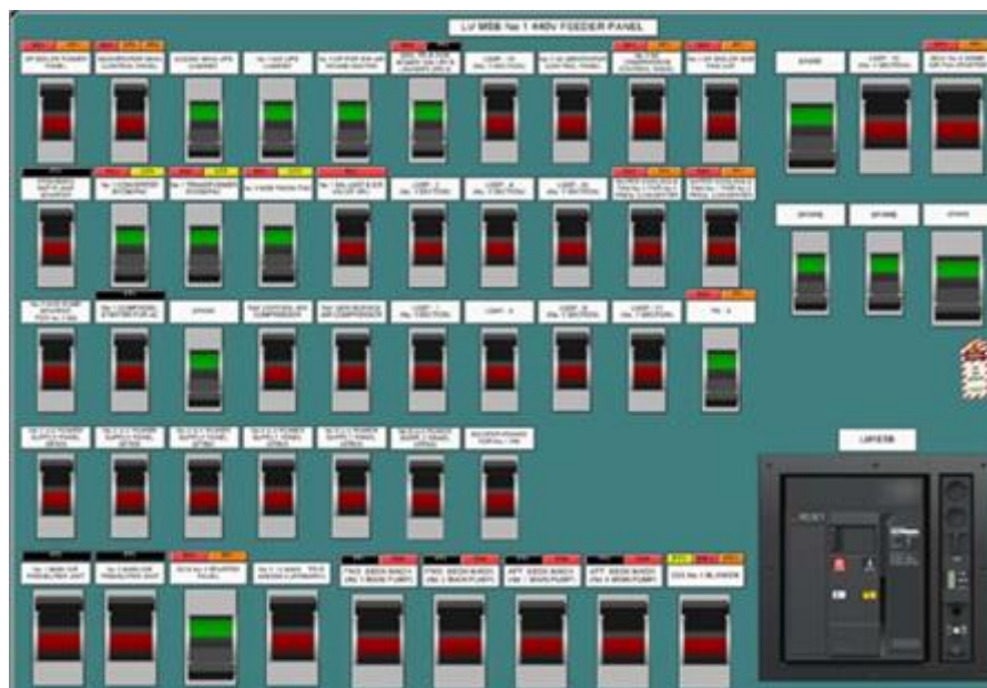
Slika 28. Napojna niskonaponska sklopna ploča GSP 1 440 V
