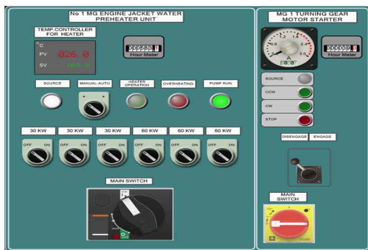
Slika 8. Upravljački panel pomoćne opreme glavnog generatora 1
