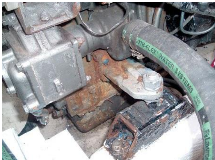
Slika 32. Korozija na dijelu strojnog uređaja [9]
