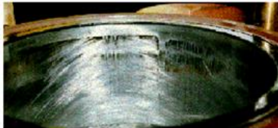
Slika 17. Pepelom oštećene površine košuljica [10]
