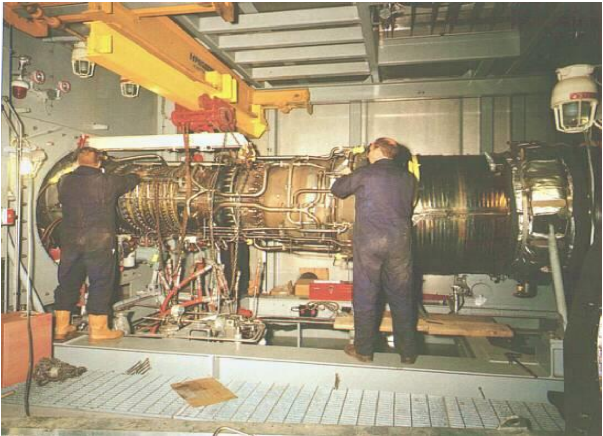
Slika 25. Plinska turbine na brodu Millenium[7]
