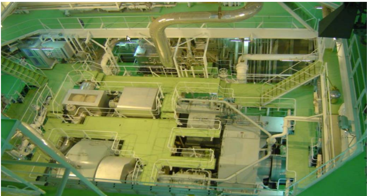
Slika 22. Strojarnica parnoturbinskog pogona
