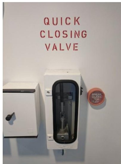
Slika 4. Hidraulička pumpa za daljinsko zatvaranje brzozatvarajućeg ventila na sustavu goriva EDG.
