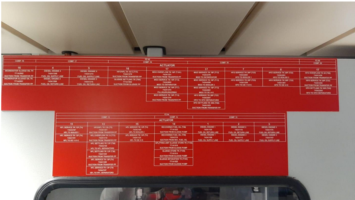
Slika 15. Primjer daljinski zatvaranih uređaja brzozatvarajućim ventilma.
