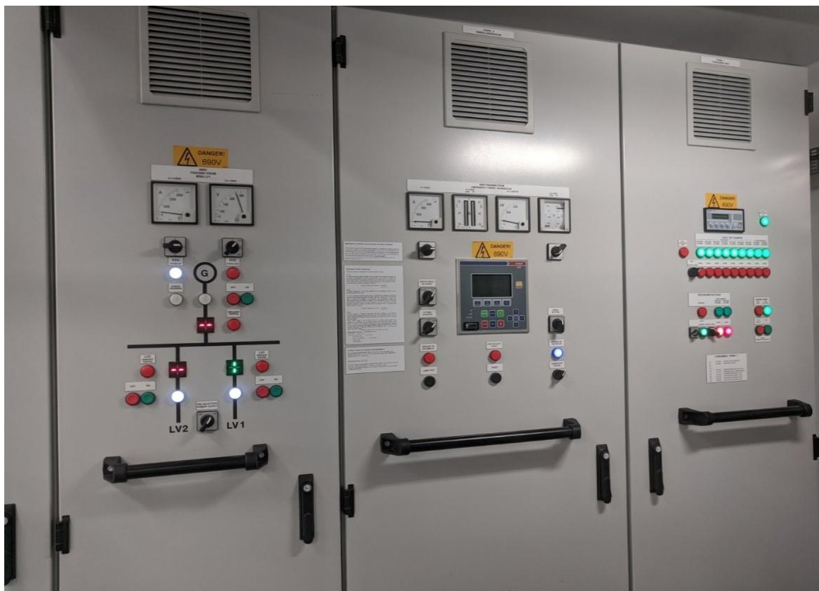
Slika 6. Ormar s upravljanjem umrežavanja EDG na glavnu električnu mrežu.
