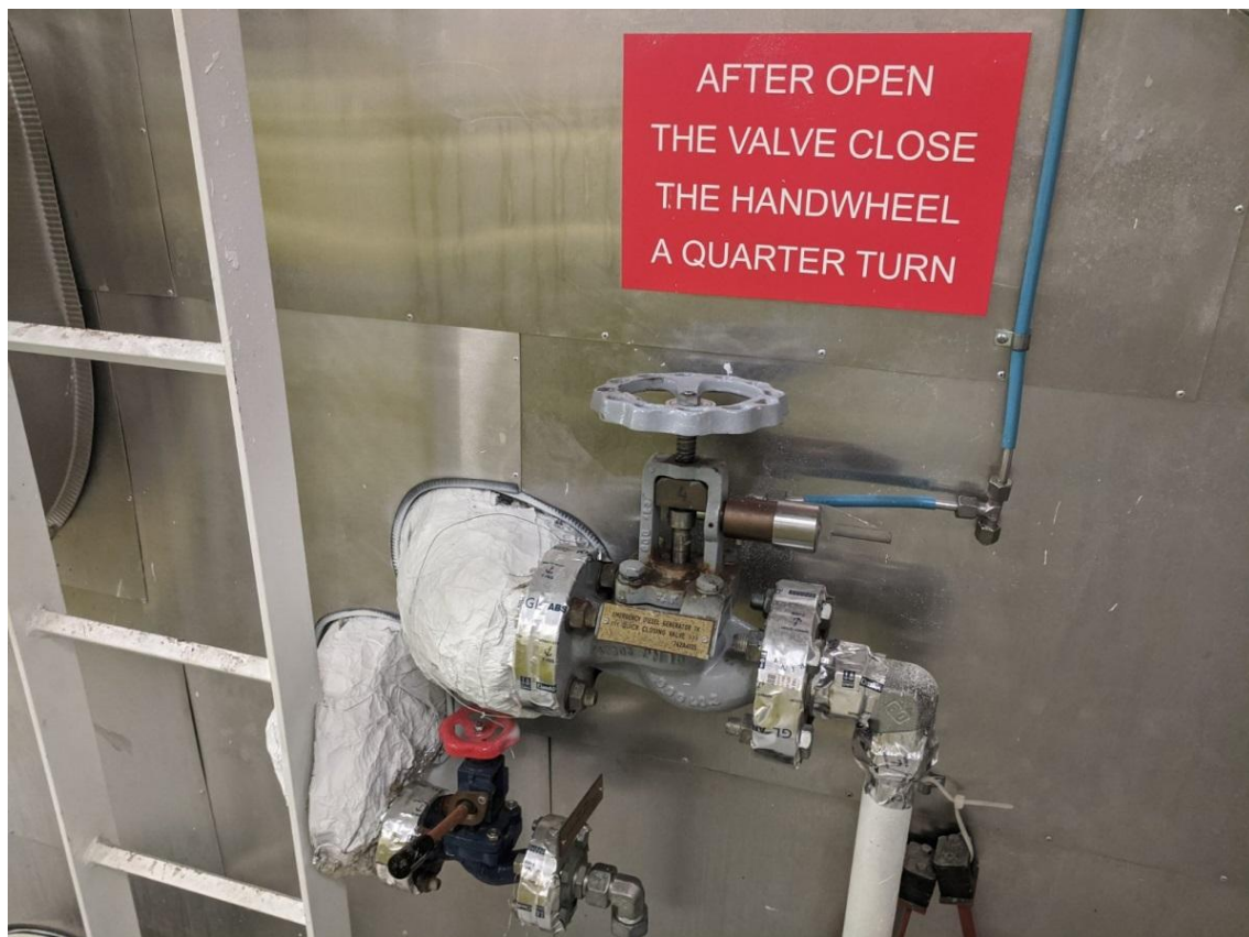
Slika 13. Brzotvarajući ventil s upozorenjem – Nakon potpunog otvaranja ventila pritvoriti ga za četvrtinu kruga.
