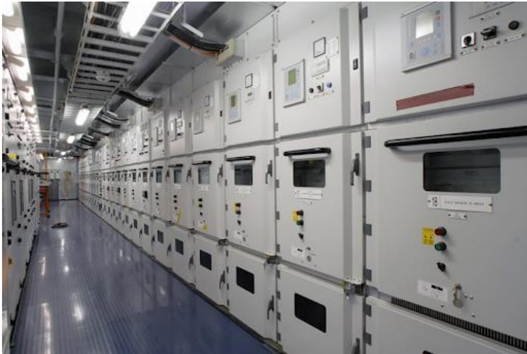
Slika 3. Glavna sklopna ploča [7]
