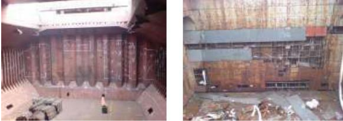
Slika 11. Korodirana nepropusna poprečna/uzdužna pregrada skladišta spremna za zamjenu (Prema: Ivošević, Špiro, Održavanje i bezbjednost broda , 2016.)
