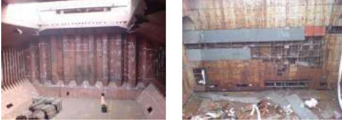
Slika 11. Korodirana nepropusna poprečna/uzdužna pregrada skladišta spremna za zamjenu (Prema: Ivošević, Špiro, Održavanje i bezbjednost broda , 2016.)
