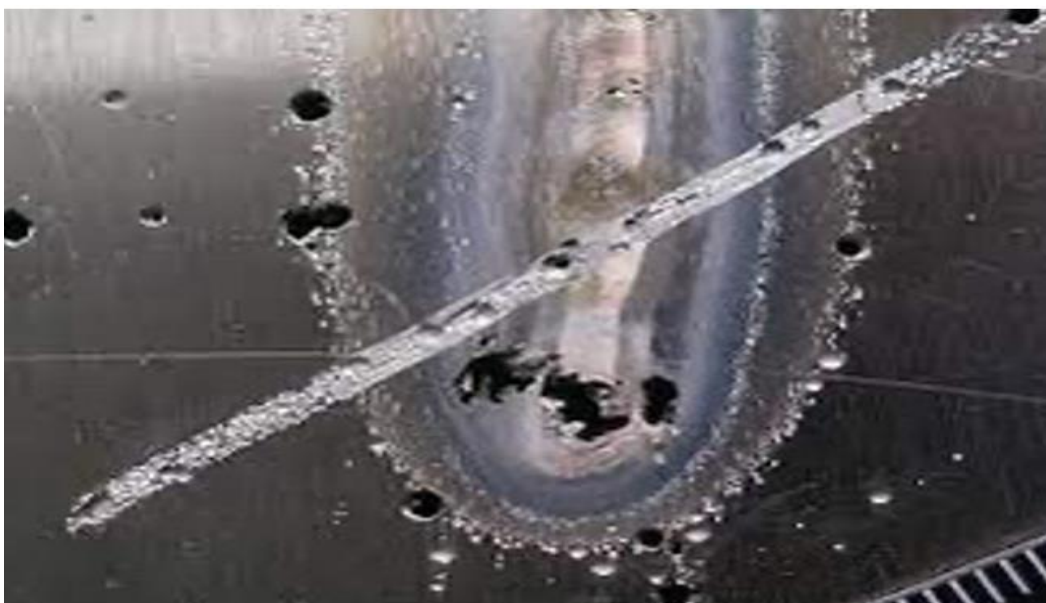
Slika 28. Rupičasta korozija u cijevi [5]
