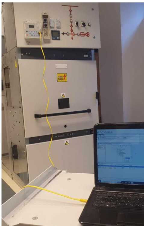
Slika 19. Visokonaponski laboratorij na Pomorskom Fakultetu u Splitu, Laptop priključen na relej
