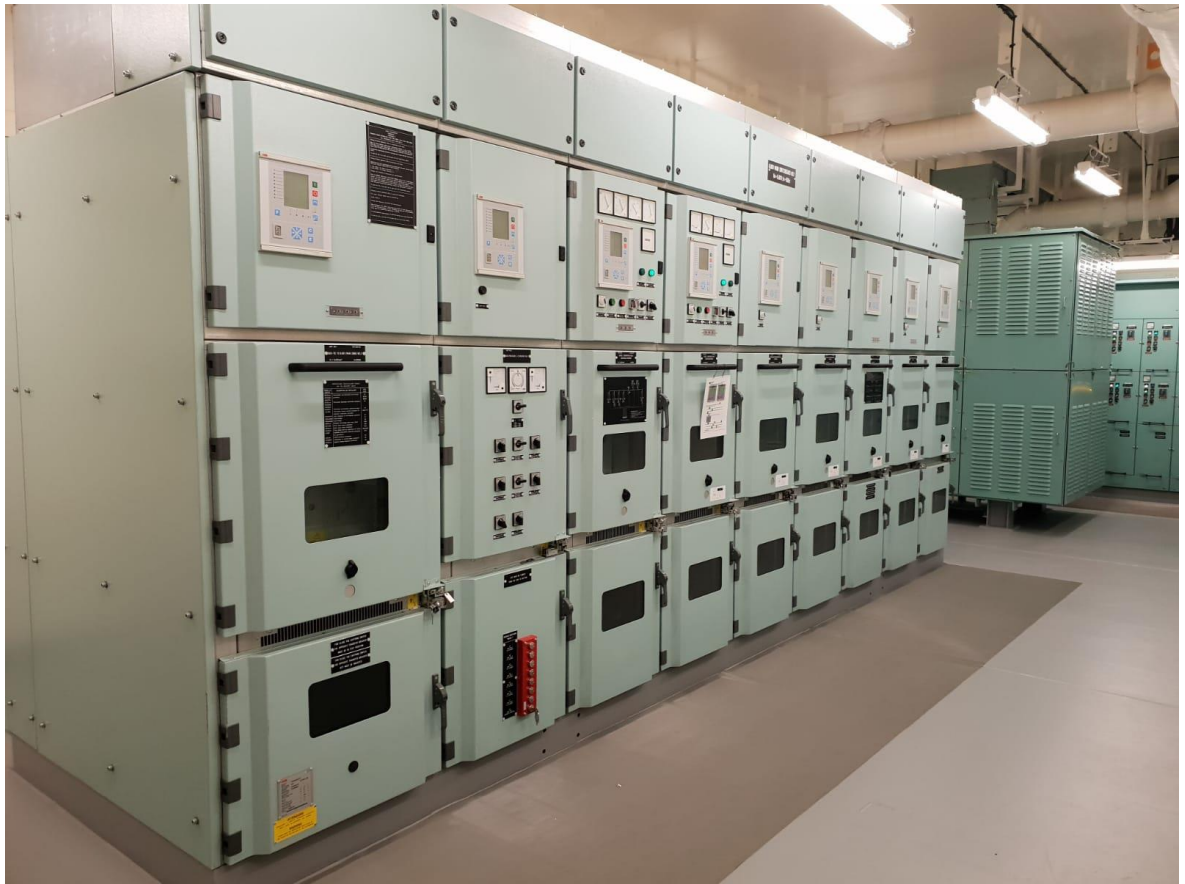
Slika 17. Numerički zaštitni releji u visokonaponskom postrojenju
