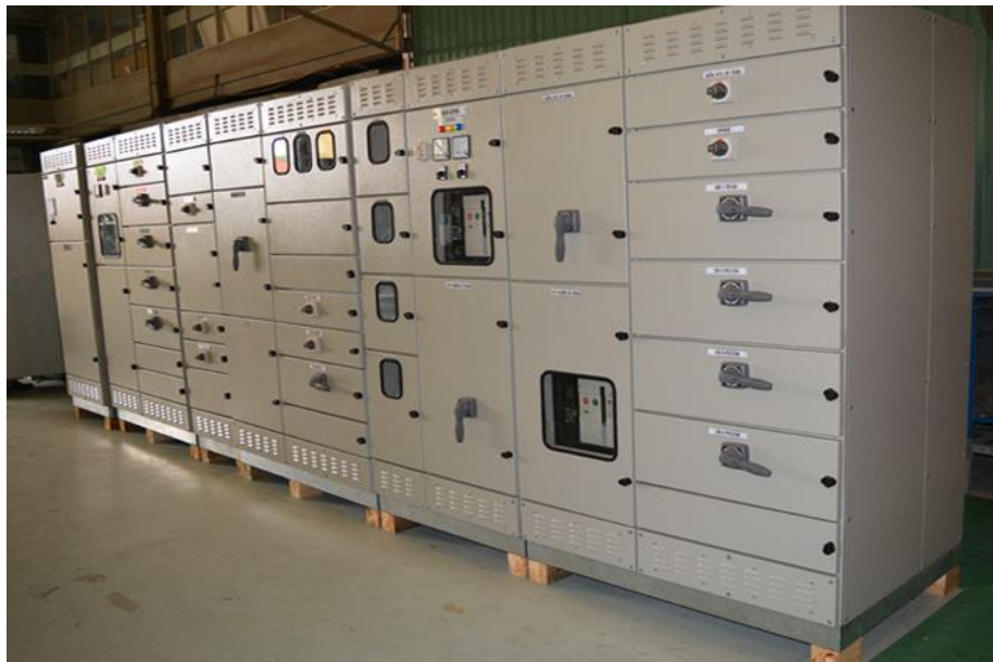
Slika 6. Glavna rasklopna ploča [17]
