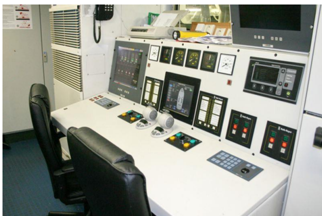
Slika 48. Komande upravljanja iz kontrolne sobe strojarnice [40]
