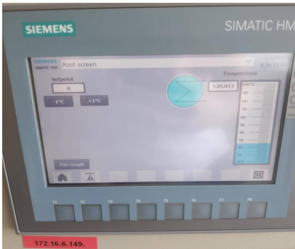
Slika 32 Prikaz glavnog ekrana od PID kontrolera
