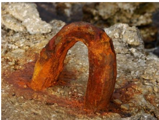
Slika 3. Progresivni gubitak materijala zbog erozije [6]
