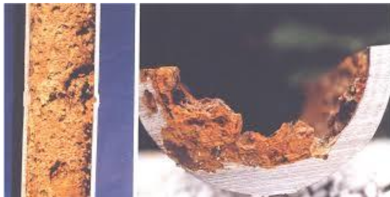
Slika 6. Mikrobiološki poticana korozija [9]
