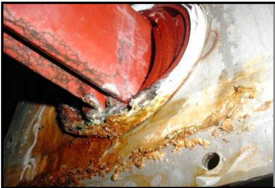
Slika 48. Kvar uzemljenja sustava sabirnica od 11 kV. Vjerojatni uzrok: nepravilan izolacijski materijal i vlaga [1]
