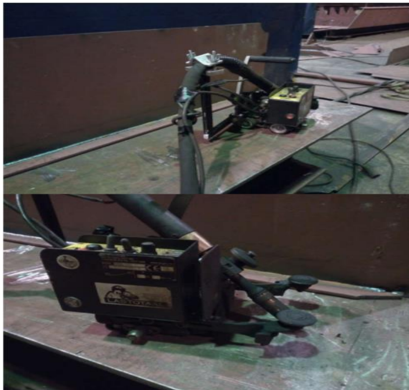
Slika 11. Zavarivanje pomoću automatskog MIG aparata za zavarivanje kojim se pojednostavljuje postupak zavarivanja dugih ravnih profila [14]
