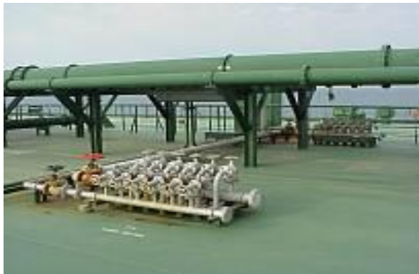
Slika 16. Sustav grijanja tereta na palubi
