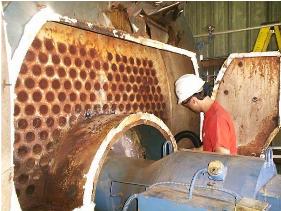
Slika 14. Korozija generatora pare [18]
