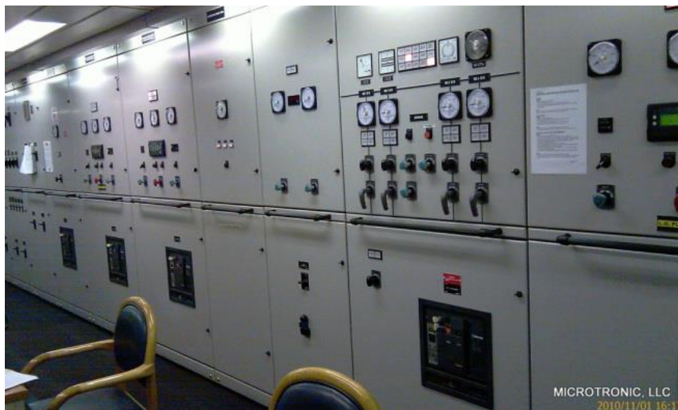
Slika 19. Prikaz glavne sklopne ploče [9]
