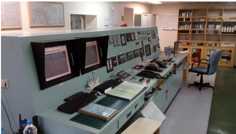
Slika 6.6. Upravljačka ploča glavnog motora
