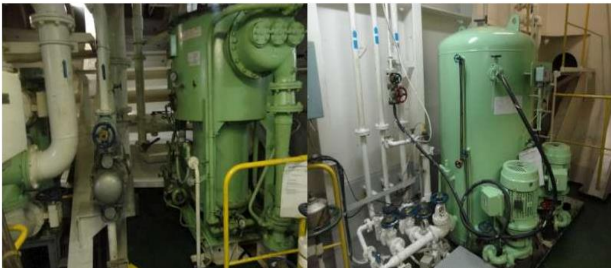
Slika 5. Generator slatke vode na LNG brodu [11]
