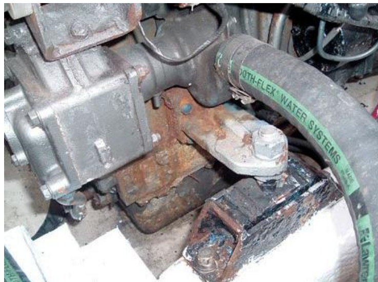
Slika 32. Korozija na dijelu strojnog uređaja [9]
