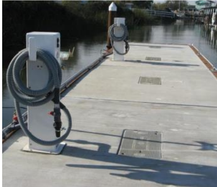
Slika 4. Pumpa za prikupljanje otpadnih voda [39]
