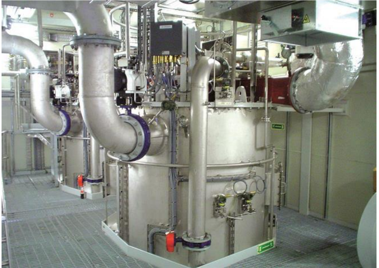
Slika 21 Generator inertnog plina
