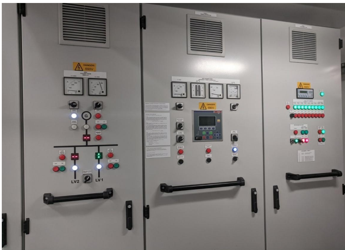
Slika 6. Ormar s upravljanjem umrežavanja EDG na glavnu električnu mrežu.
