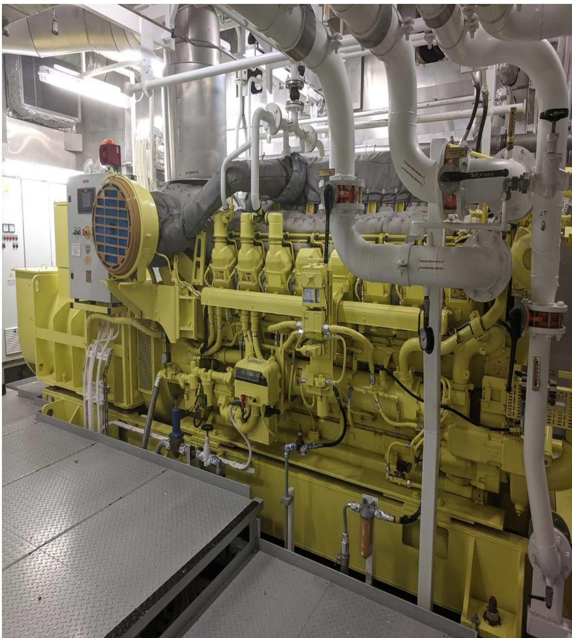
Slika 5. Dizel-generator u nužnosti.
