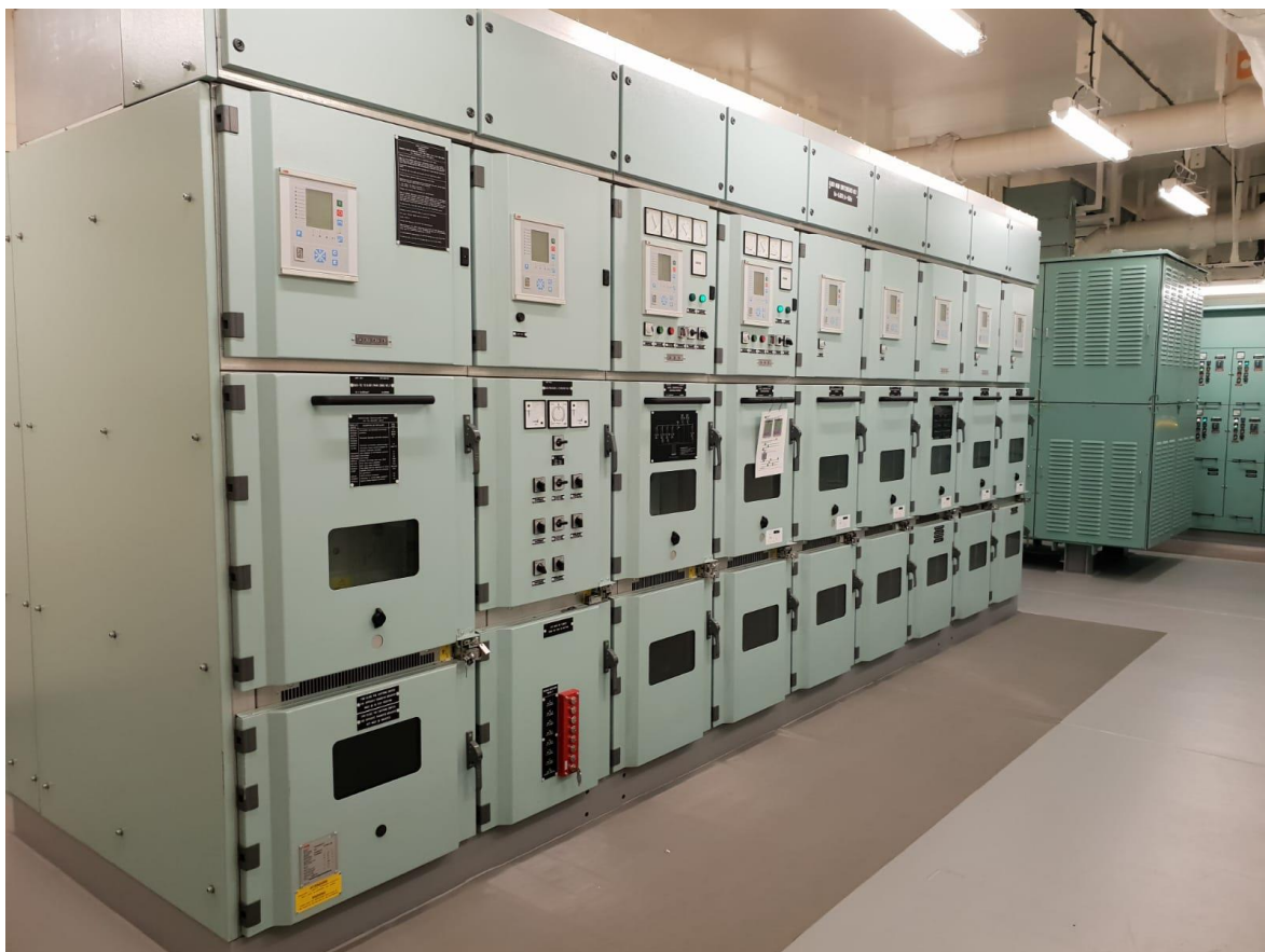
Slika 17. Numerički zaštitni releji u visokonaponskom postrojenju
