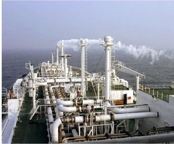
Slika 24. Ispuštanje BOG-a u atmosferu preko ventilacijskih jarbola [16]
