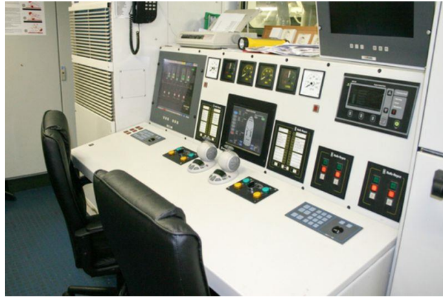
Slika 48. Komande upravljanja iz kontrolne sobe strojarnice [40]
