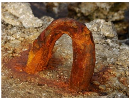
Slika 3. Progresivni gubitak materijala zbog erozije [6]
