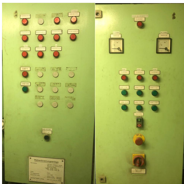
Slika 18. Prikaz kontrola na uređaju za spaljivanje na brodu
