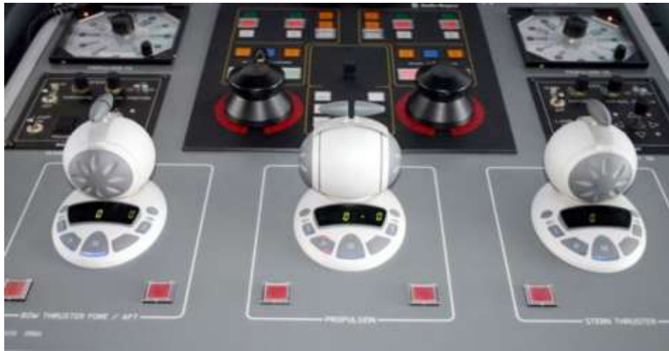
Slika 46. Komande na mostu [26]
