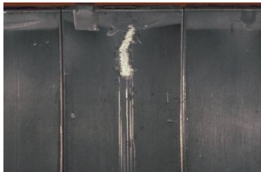
Slika 34. Oštećenje uzrokovano kavitacijskom erozijom [6]
