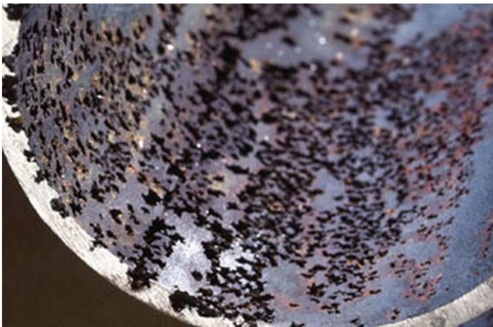
Slika 15. Točkasta (pitting) korozija u cijevi generatora pare [24]
