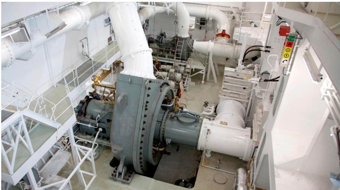
Slika 78. Pumpna stanica na TSHD jaružalu [38]
