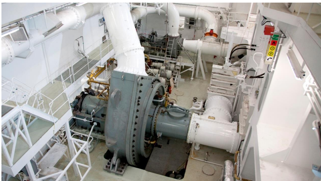
Slika 78. Pumpna stanica na TSHD jaružalu [38]
