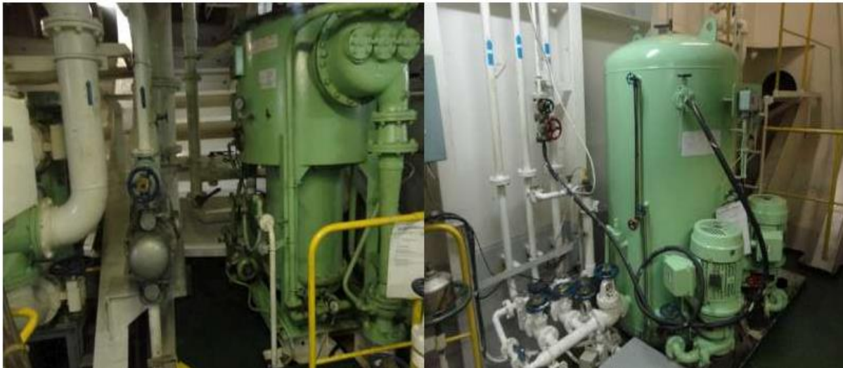
Slika 5. Generator slatke vode na LNG brodu [11]
