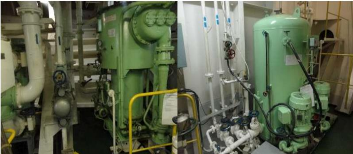
Slika 5. Generator slatke vode na LNG brodu [11]
