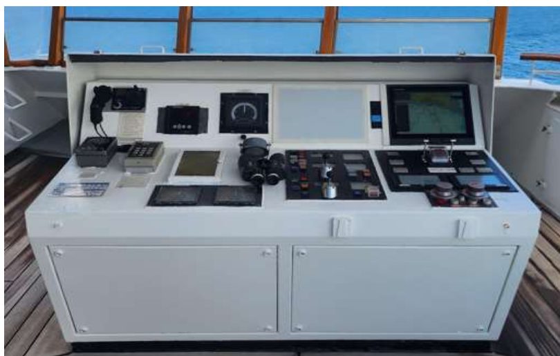
Slika 12. Stanica za manevriranje na krilu mosta
