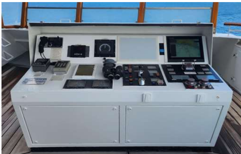
Slika 12. Stanica za manevriranje na krilu mosta
