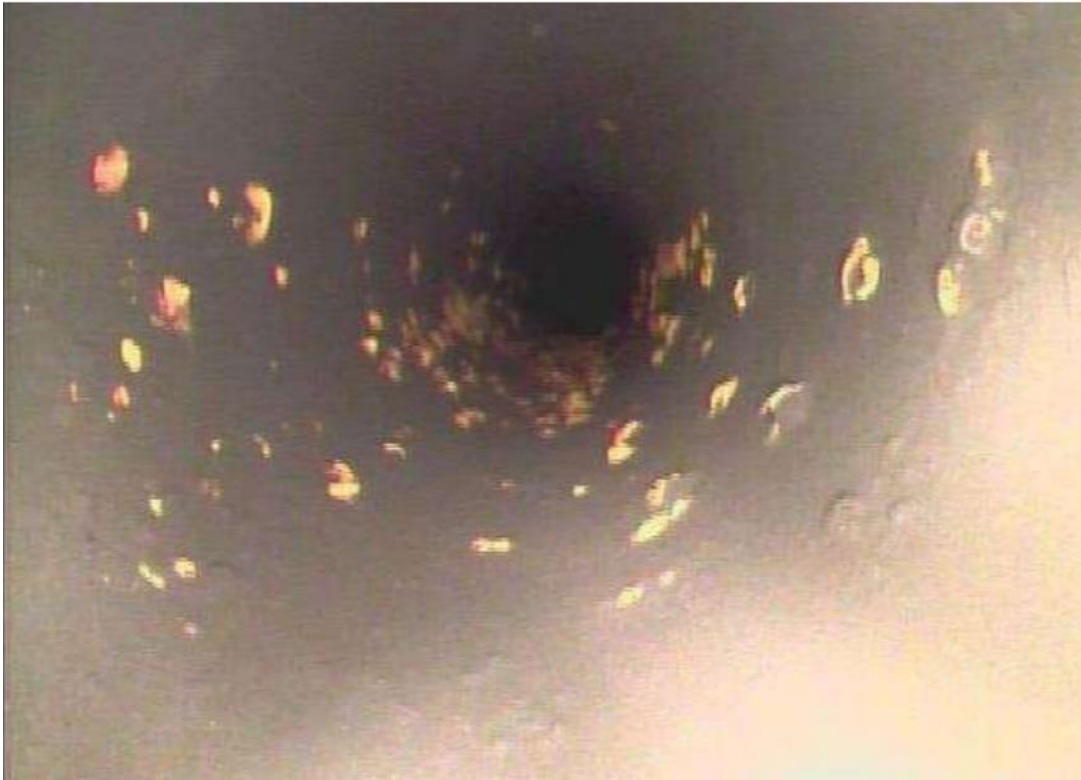
Slika 29. Korozijska oštećenja cijevovoda u kotlu[19]
