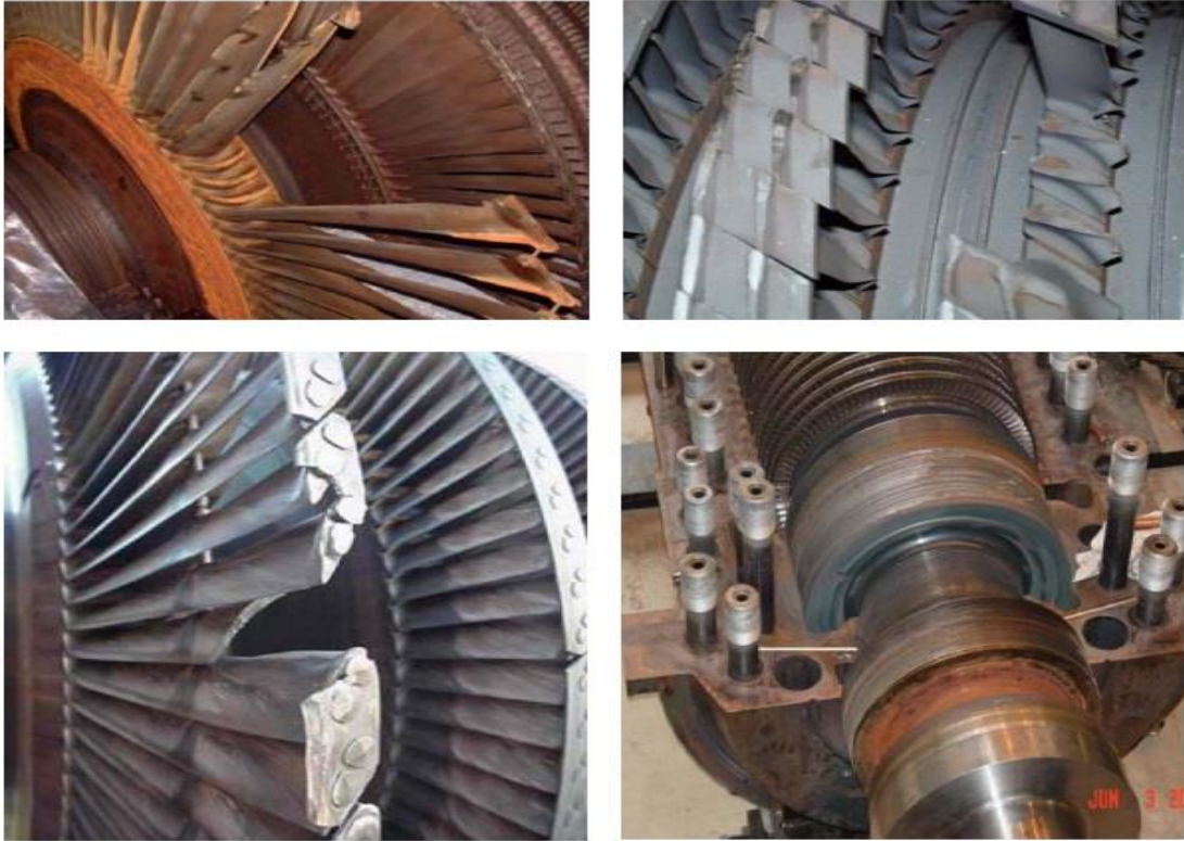
Slika 27. Oštećenja pojedinih komponenti turbinskog postrojenja zbog djelovanja erozije i korozije[19]
